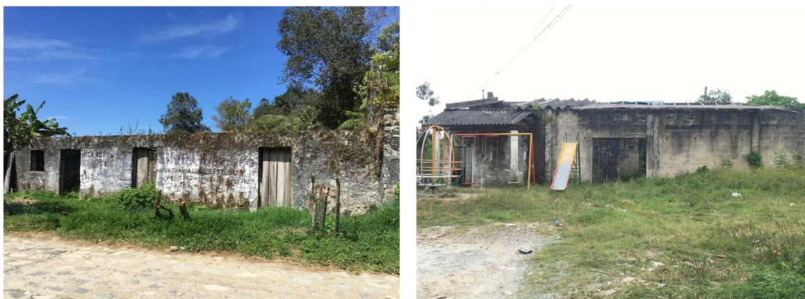
Figura 2.17. Viviendas abandonadas en las localidades de Xocoyolo y Huaxtitán
