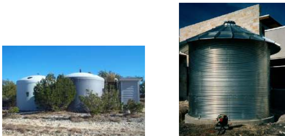
Figura 4.10 Tanques de 10 000 galones de fibra de vidrio y tanque de acero galvanizado
