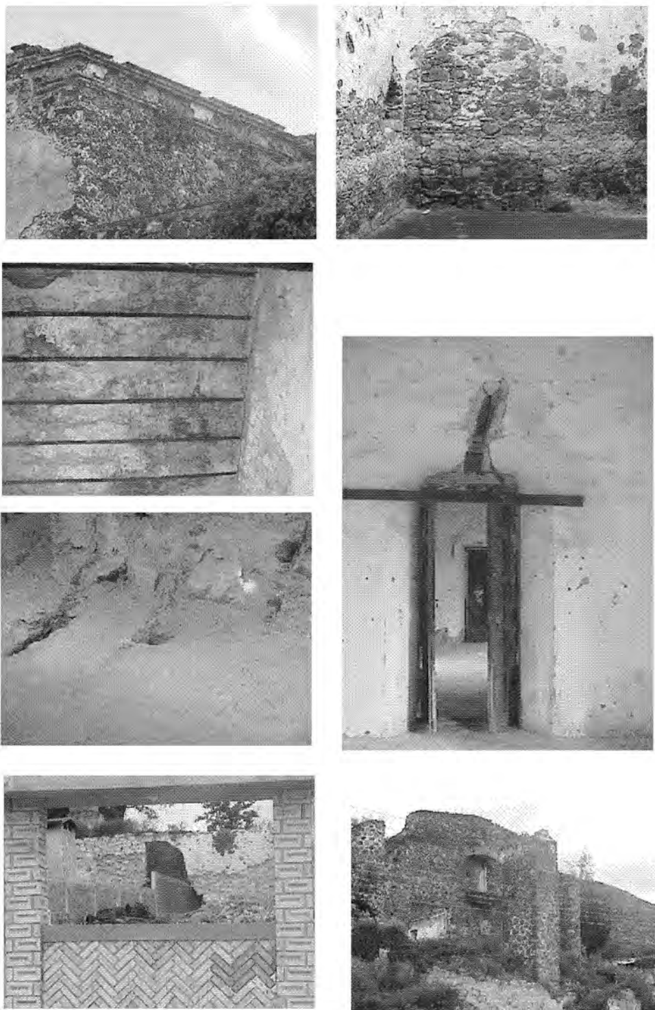
Figura 34. Se observa el deterioro en las edificaciones del casco por abandono, colapso, extracción de materiales, agresión, y demolición para nuevas construcciones. Ejemplos: cornisas, perforaciones en muros, Filtración en azoteas que oxida los rieles de las bóvedas (se observa el goteo en el piso), extracción de la clave en segundo piso; los pobladores valoran más las nuevas construcciones que los vestigios de la Hacienda. MADMP O3
