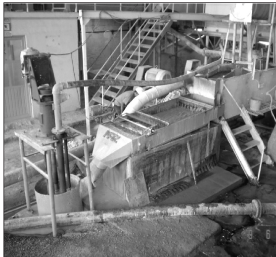
Figura 5, Vista de toda la instalación de la celda de flotación MAZ en la compañía Fluorita de México S.A. de C.V.
