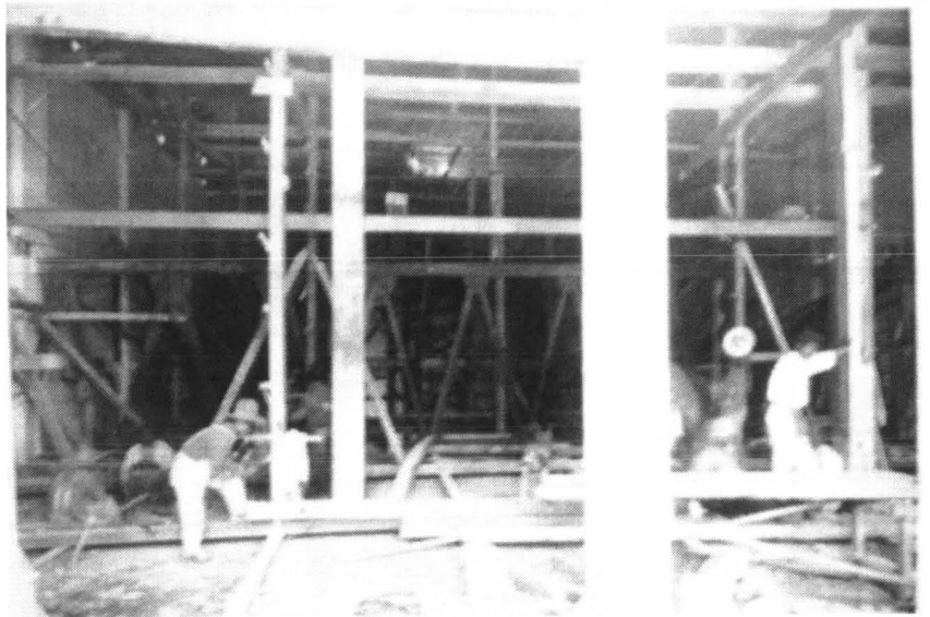
Construcción del Teatro Azteca Fotografía proporcionada por familia Lasso de la Vega y Nava
