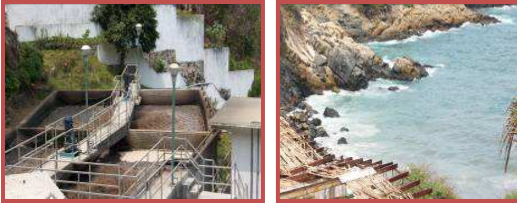
Figura 31: Fotografía a y b. Descarga de Agua residual en playa olvidada. Planta de Tratamiento la Mira en mal funcionamiento. Fuente: Luis Solís, 2010.
