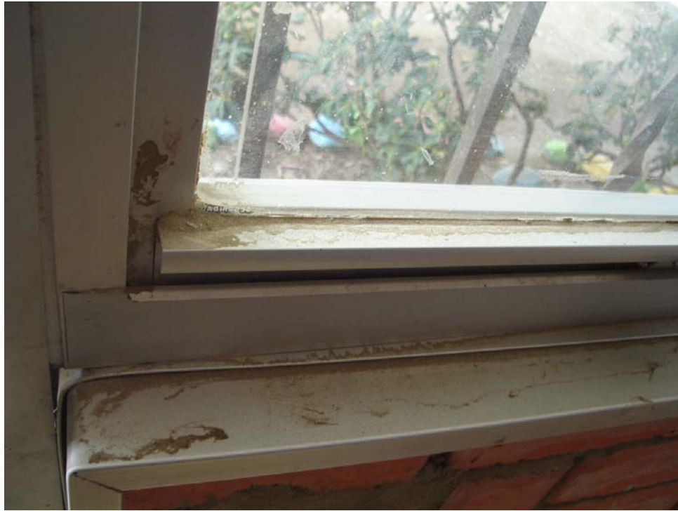
Figura 49. Partículas y polvo sobre el alfeizar de una ventana en el interior del centro escolar localizado en la Colonia Real de Minas del Municipio de Villa de la Paz, S.L.P.
