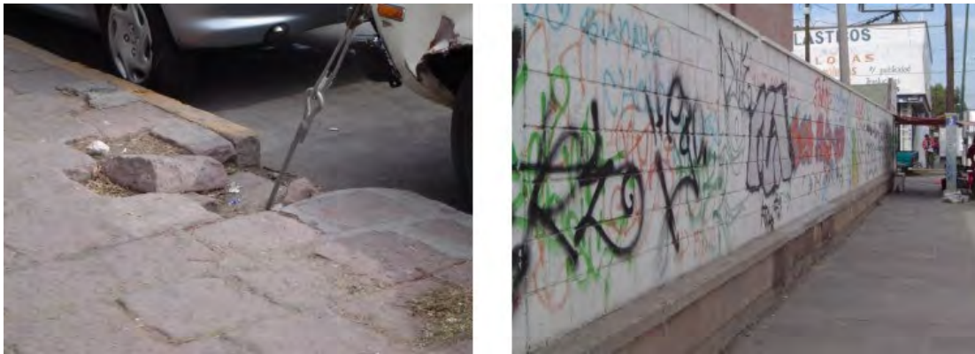
Fotografía 26. Graffiti y pavimentos en mal estado.
