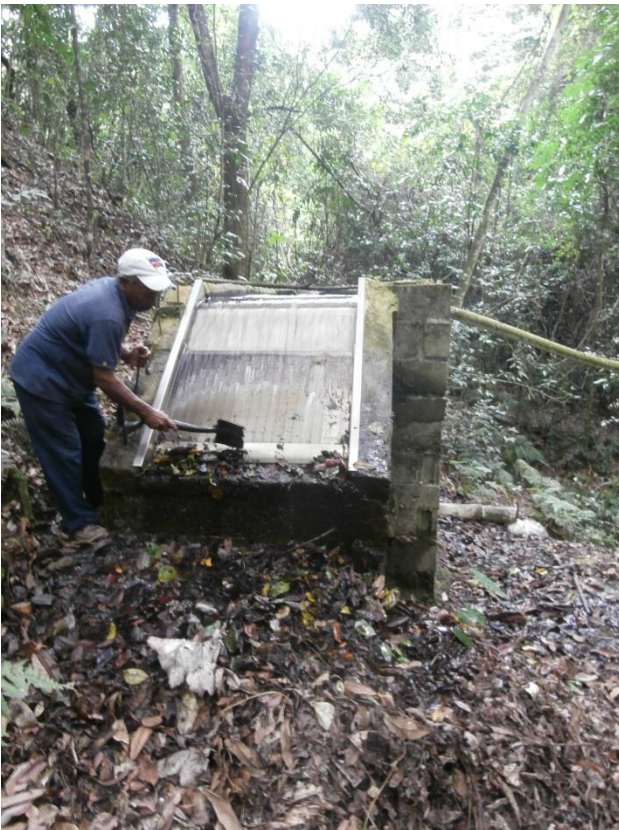
Photo 6. Grit removal Paso de la Perra
