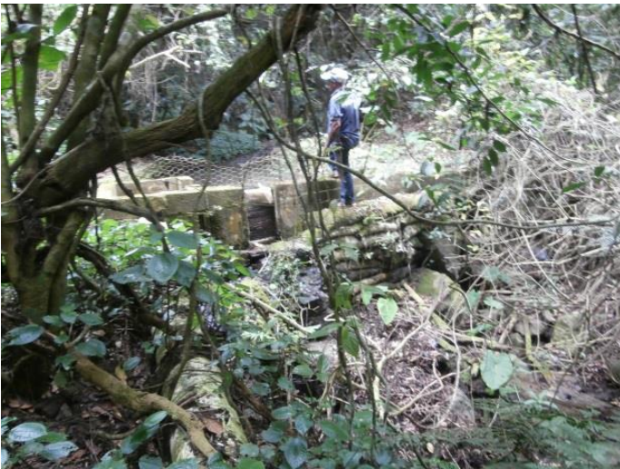
Photo 8. Water intake Paso de la Perra
