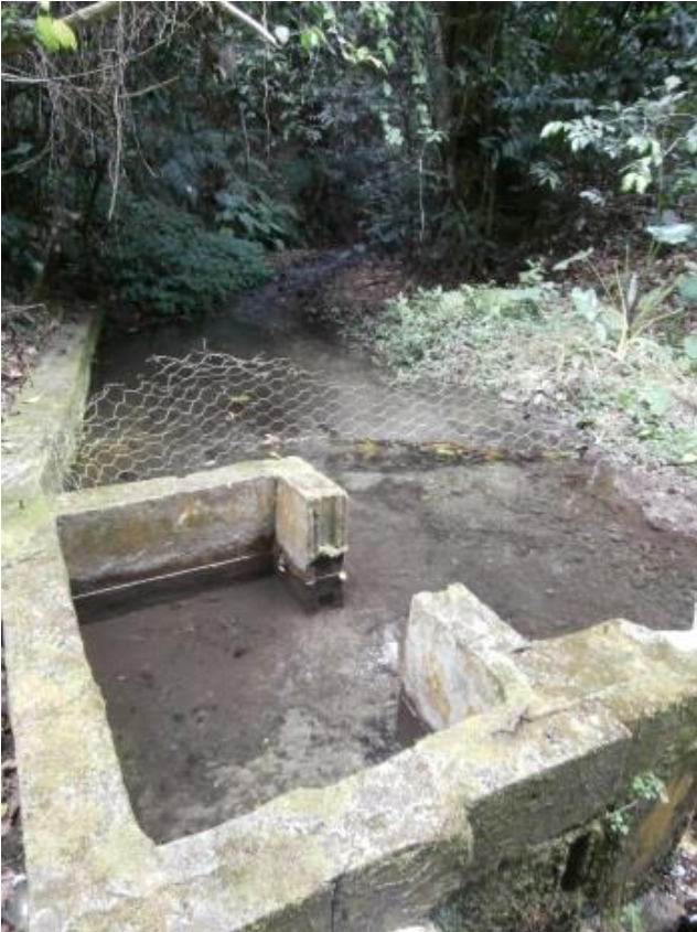
Photo 7. Water intake Paso de la Perra
