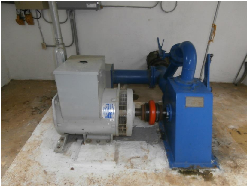
Photo 2. Equipment Paso de la Perra
