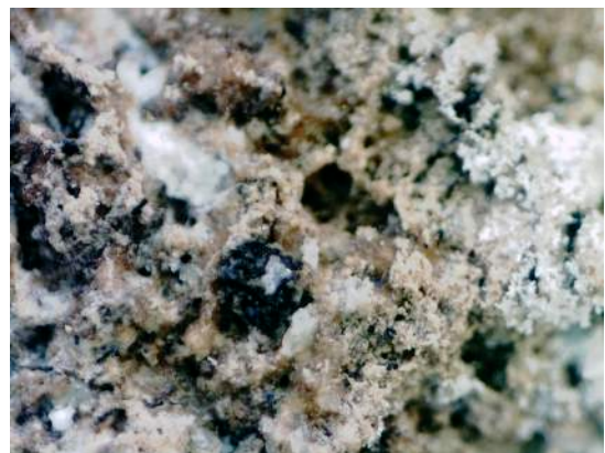
Fig. 101. Disgregación de la andesita NC07 y cristalización de sales.
