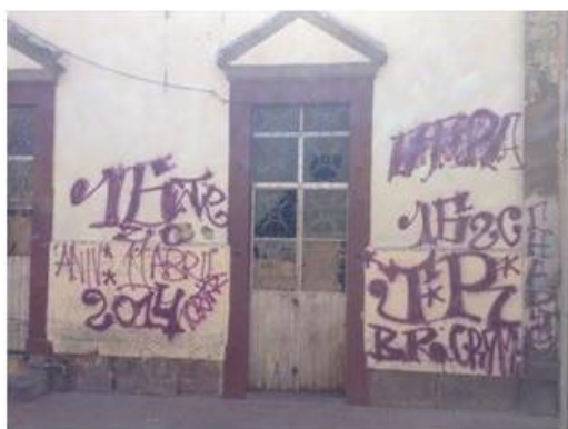
Vandalismo. Barrio de Tlaxcala, calle Ignacio Altamirano.
