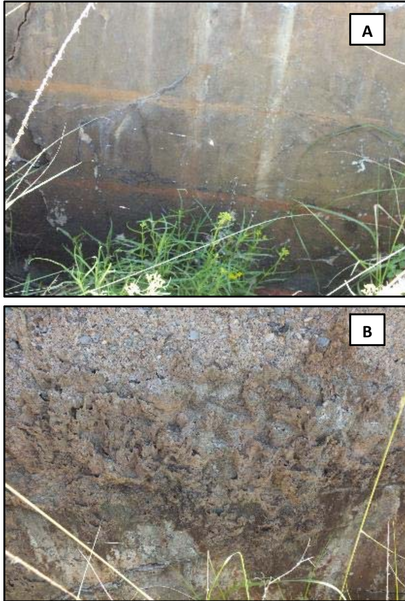
Figura 3. 14. Detalles de (A) óxidos y (B) eflorescencias en las piletas de lixiviación de jales de amalgamación en El Caballo, Cedral, San Luis Potosí.
