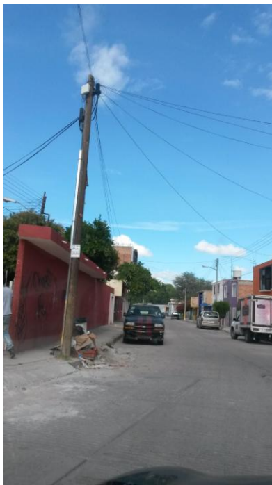
Fuente: Datos recabados por observación.
