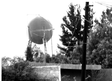
Tanque de agua que se encuentra en Emiliano Zapata.
