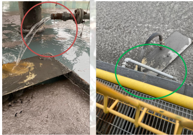
Figura 3: Modificación de puntos de dosificación de floculante.
